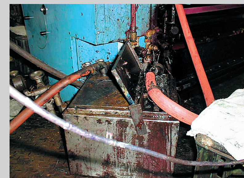
Überlastung eines schlecht gewarteten Zwischentanks. Foto Technotrans.
